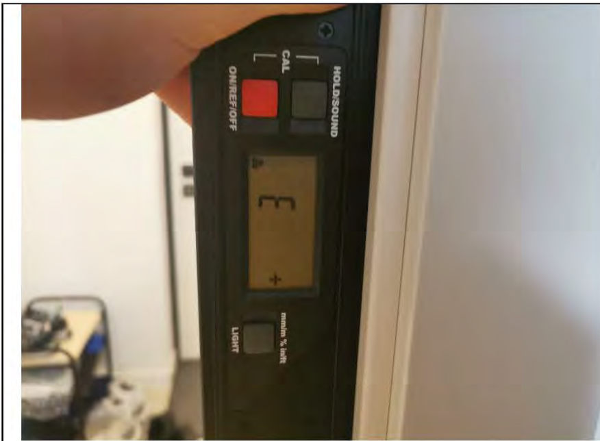
Фото №46. Отклонение коробки деревянного дверного блока в детской.
