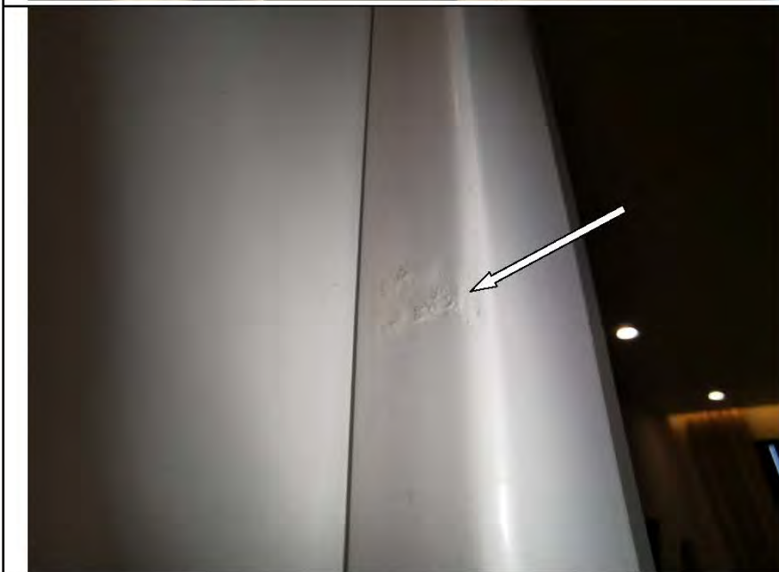
Фото №47. Загрязнения на коробке деревянного дверного блока в санузле.
