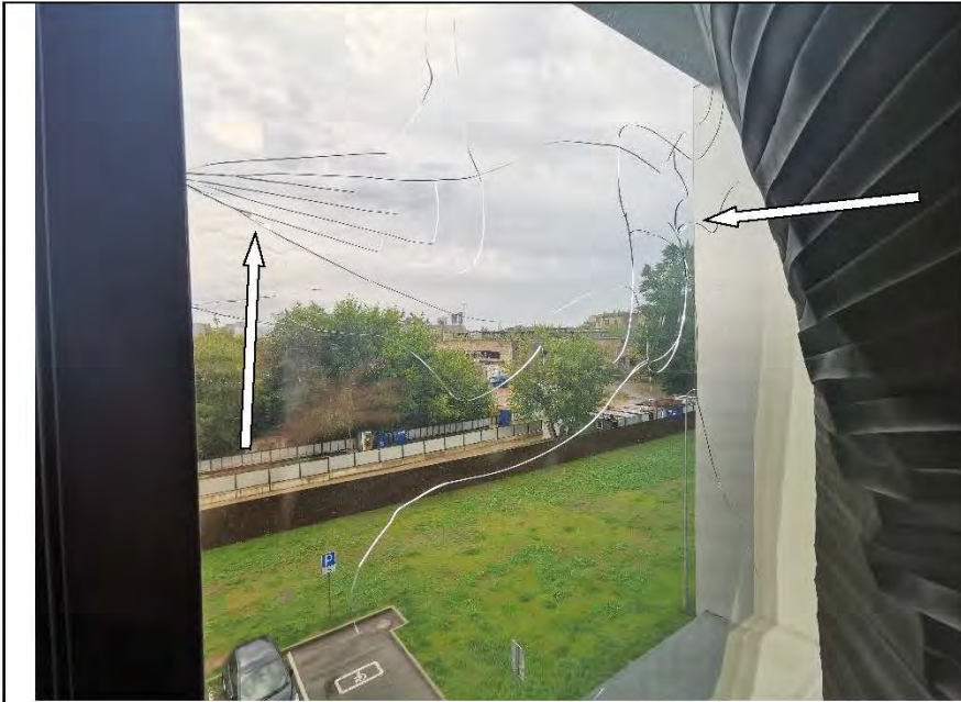
Фото №40. Трещины на стеклопакете металлического оконного блока в детской.
