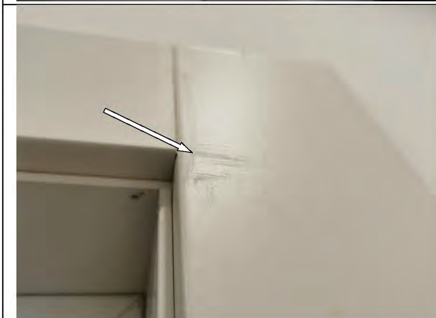
Фото №51. Царапины на наличниках деревянного дверного блока в детской.
