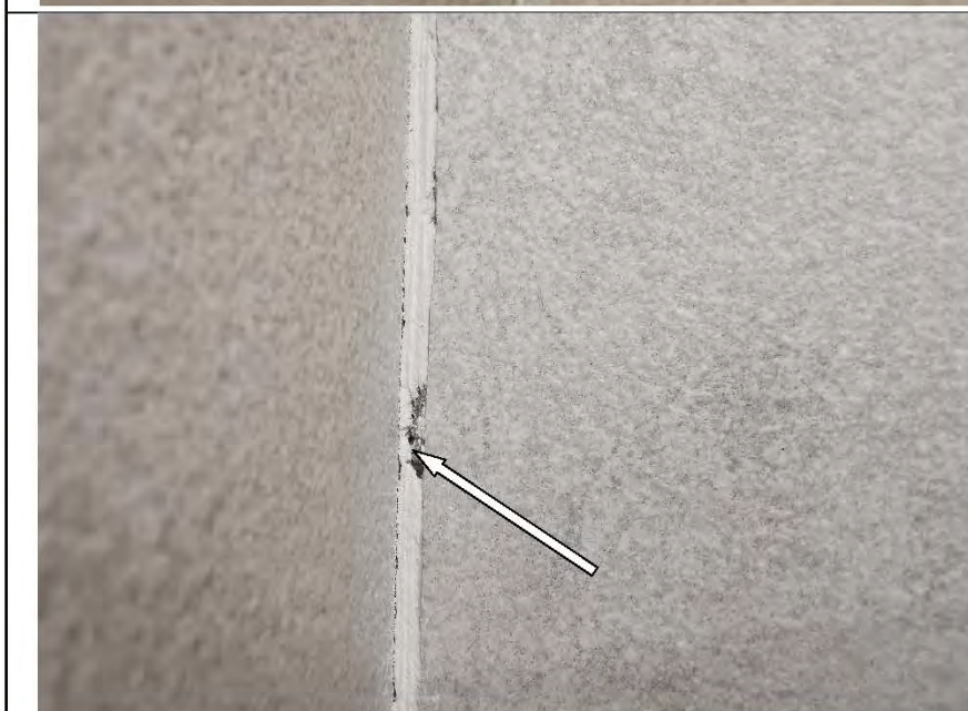
Фото №15. Неполное заполнение швов настенной керамической плитки в ванной комнате.
