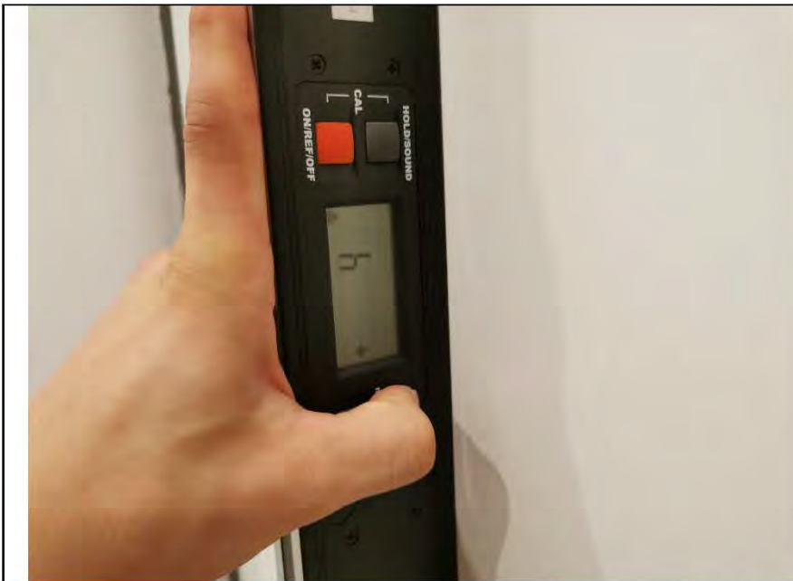
Фото №55. Отклонение полотна от плоскостности и прямолинейности входного дверного блока.
