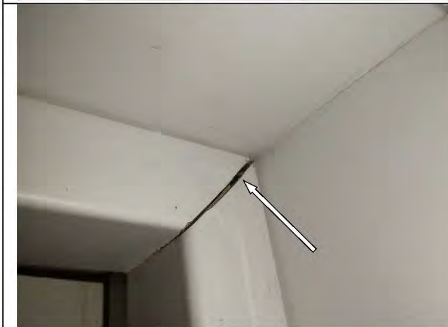
Фото №53. Ненадежное соединение элементов деревянного дверного блока (коробки) в спальне.
