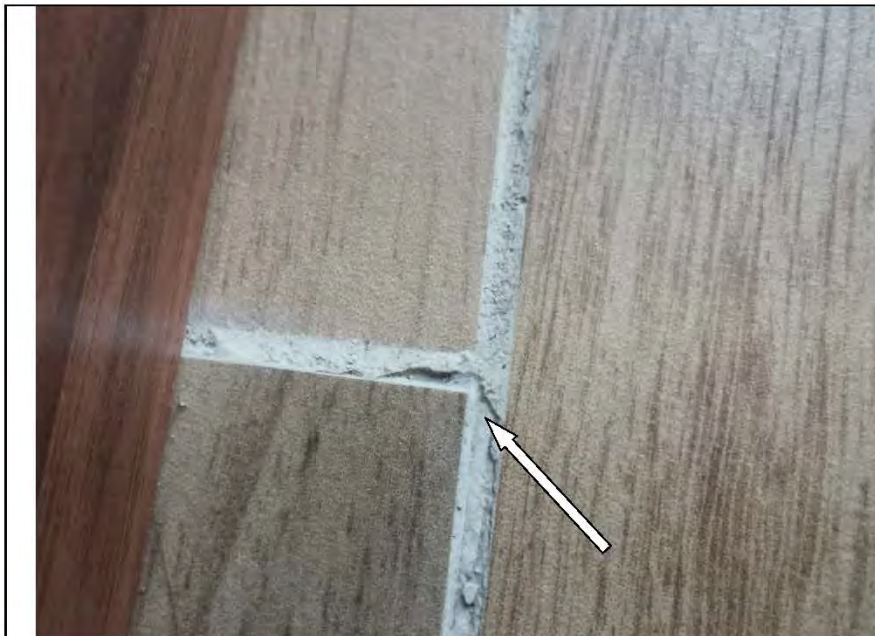
Фото №28. Неполное заполнение шовного пространства напольной керамической плитки в кухне.
