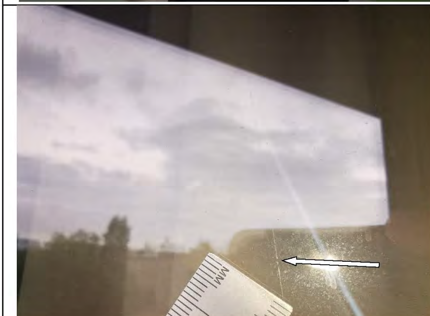
Фото №38. Царапины на стеклопакете металлического оконного блока в кухне.
