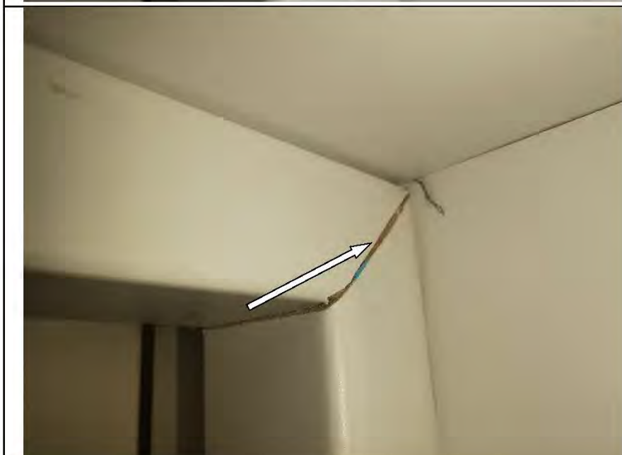
Фото №54. Ненадежное соединение элементов деревянного дверного блока (коробки) в ванной комнате.
