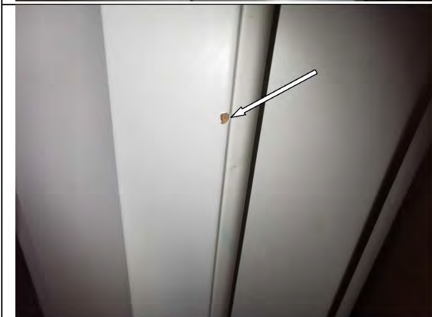
Фото №48. Потертости на коробке деревянного дверного блока в санузле.
