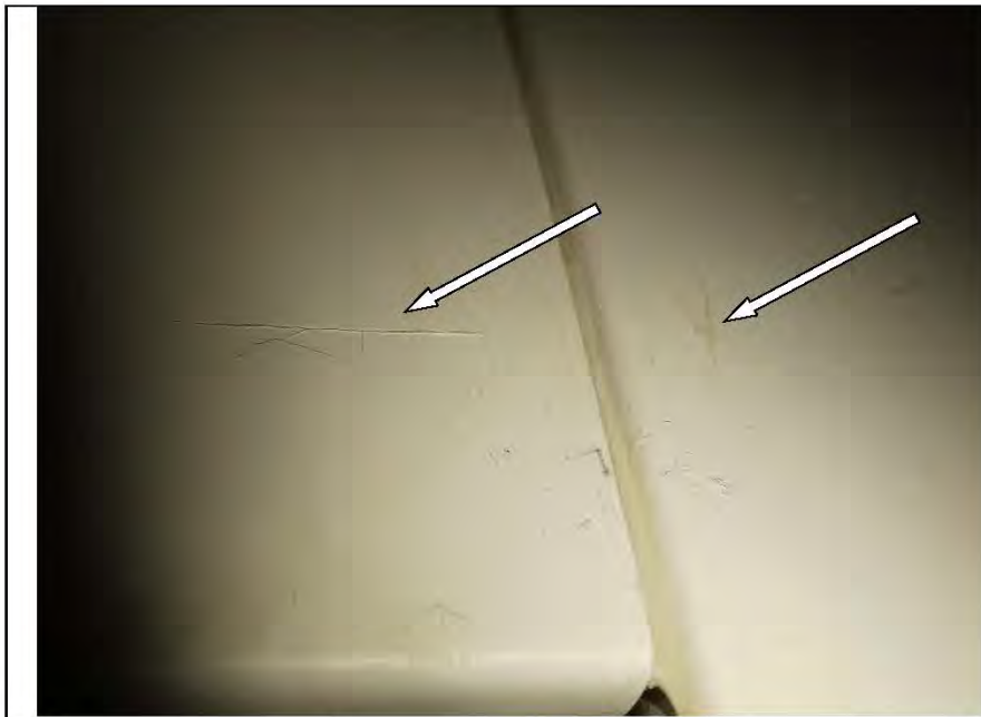
Фото №49. Загрязнения и царапины на наличниках деревянного дверного блока в спальне.
