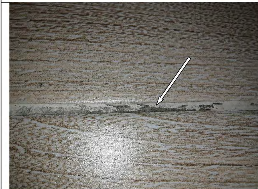
Фото №27. Неполное заполнение шовного пространства напольной керамической плитки в санузле.
