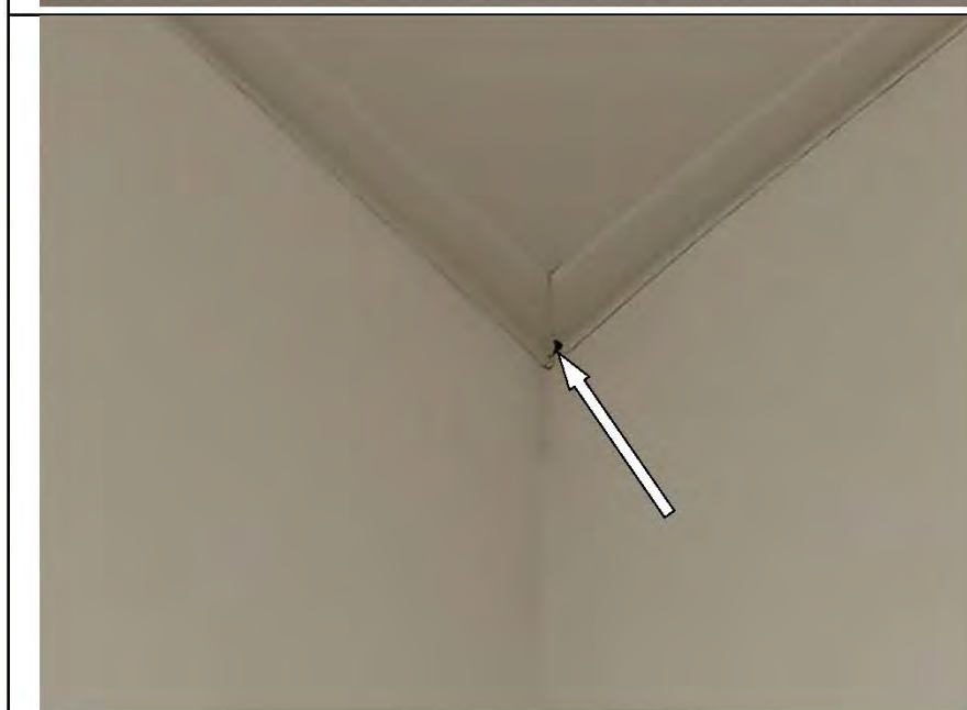
Фото №33. Дефект монтажа декоративного молдинга крепления натяжного потолка в коридоре.
