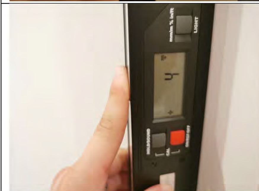
Фото №45. Отклонение коробки деревянного дверного блока в ванной комнате.
