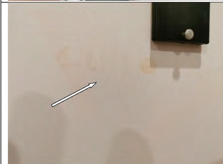
Фото №56. Полотно входного дверного блока имеет дефекты (загрязнение).
