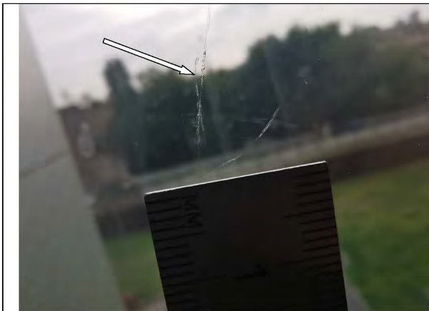
Фото №37. Царапины на стеклопакете металлического оконного блока в кухне.
