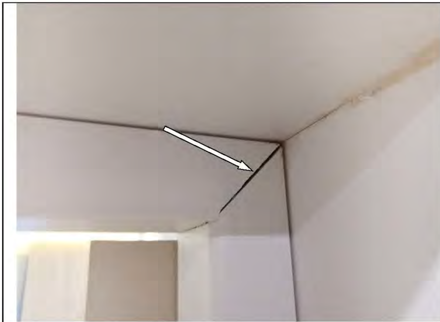
Фото №52. Ненадежное соединение элементов деревянного дверного блока (коробки) в санузле.
