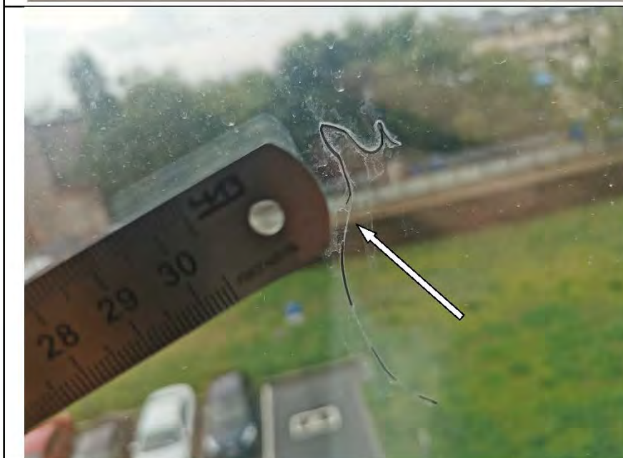
Фото №35. Загрязнение стеклопакета металлического оконного блока в спальне.
