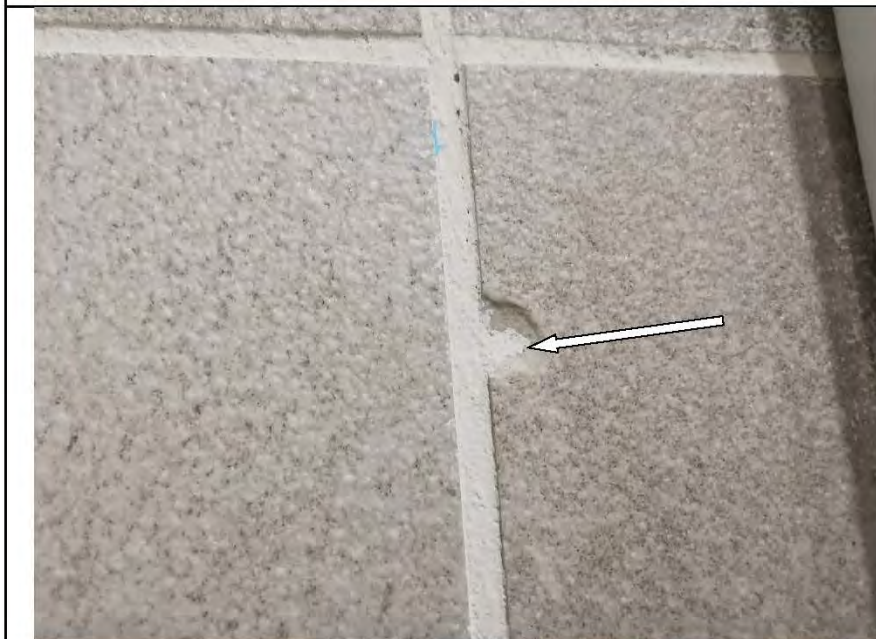
Фото №18. Отбитость настенной керамической плитки в ванной комнате.
