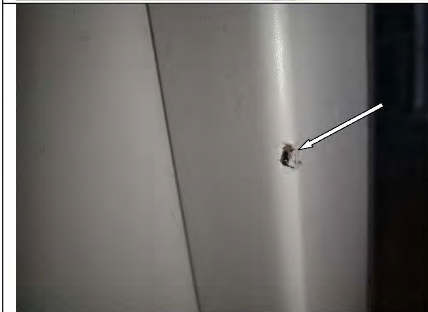
Фото №50. Потертости на коробке деревянного дверного блока в ванной комнате.
