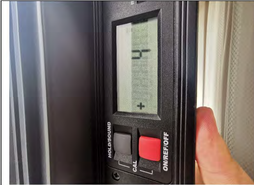
Фото №43. Отклонение металлического оконного блока по уровню вертикальности в детской.
